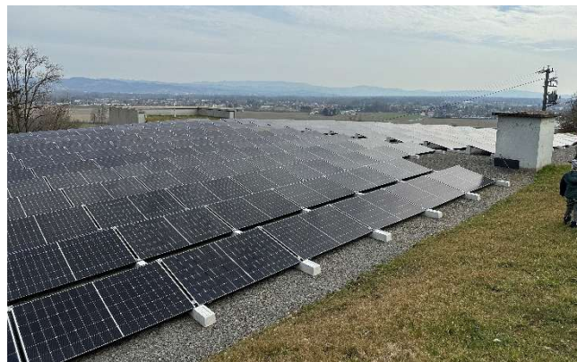
Diese Anlage erzeugte im Jahr 2025 bereits 57,17 MWh
